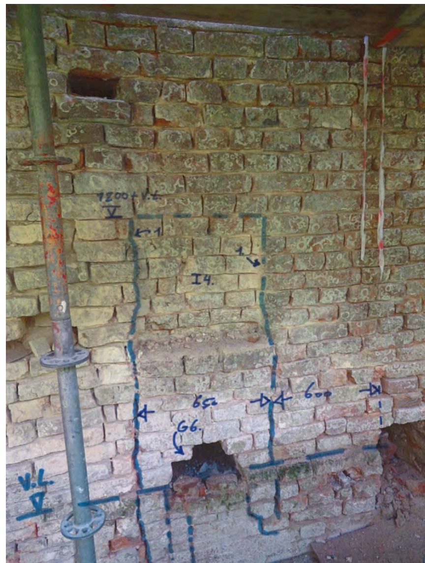
Afb. 21: Overzicht van het muurwerk waarin de sparing G6 is aangetroffen. Met I4 is de inkassing aangegeven. (afb. auteur)
