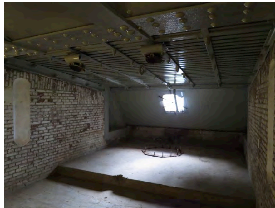
Afb. 24: Het interieur van de kazematten op fort Pannerden geeft een idee van de kazematten zoals die voorzien waren op ravelijn 5 (foto auteur)
