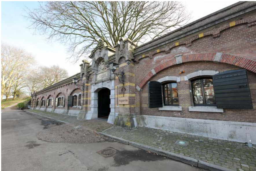
Fotoarchief Monumentenbezit, voorgevel Promerskazerne met zoutuitbloei
