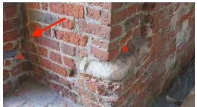
Afb. 52 De afgehakte lijst stopt bij de pijl. De A geeft de natuursteen onderdorpel van de gevelopening aan, het is de bovenkant van de borstwering. Waar de profiellijst op de eerste verdieping onder de borstwering stopt, stopt deze hier boven de borstwering. Door de verlaging van de begane grond vloer met 40cm. is dit ontstaan. De B geeft een muurstijlsleuf en natuursteen console aan die in de vierde bouwfase werd aangebracht (foto Monumentenbezit).
