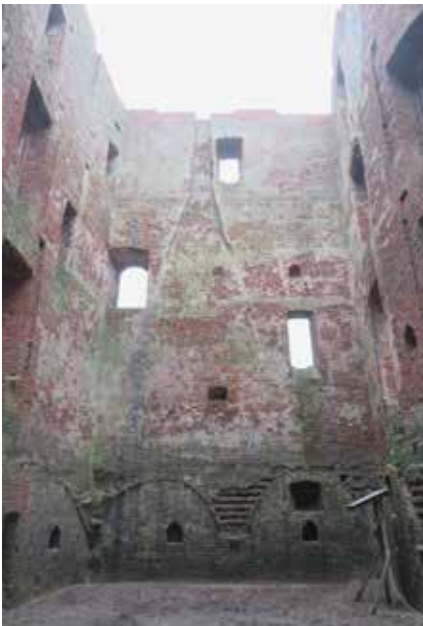
Afb. 23-24 Schematisch aanzicht van de zuidwand aangevuld met foto (tekening door auteur; foto Monumentenbezit); Deze is ca. 18m hoog en 8m breed. In de wand zijn in totaal drie openingen te zien, op de begane grond, eerste en tweede verdieping. Onder de rechter gewelfaanzet in de kelder is een diepe vierkante nis aanwezig (A). De drie openingen lijken qua vormgeving op de overige gevelopeningen. De opening op de begane grond zit erg hoog ten opzichte van het niveau van de vloer en loopt door tot vlak onder de versnijding van de eerste verdieping (B). De opening op de eerste verdieping zit op zijn beurt weer gelijk met het vloerniveau. Het is een doorgang geweest naar de ringmuur (C). De grote opening in de noordgevel is zijn evenknie. De opening op de tweede verdieping is voorzien van een zitje en sluit aan op de openingen in de andere wanden op dit niveau. Links van het midden van deze wand zijn de restanten van een haardpartij zichtbaar (D). De haardpartij start op de eerste verdieping en loopt door over de laag daarboven. Er lijkt echter alleen op de eerste verdieping een stoekplaats gezeten te hebben. Het rookkanaal loopt erg dicht langs de gevelopening op de tweede verdieping (E). Er ligt een penant van slechts twintig centimeter tussen. In deze wand zijn drie kaarsnissen zichtbaar (k). Twee in de kelder en een op de eerste verdieping. Op de begane grond is verder nog een kleine vierkante sparing zichtbaar (F). Aan de buitenzijde is goed zichtbaar dat deze in de gevel gehakt is.
