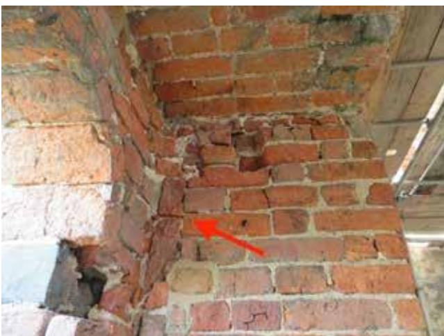
Afb. 51 Op de begane grond heeft deze omlijsting ook gezeten. De pijl geeft de afgehakte stenen aan (foto Monumentenbezit).
