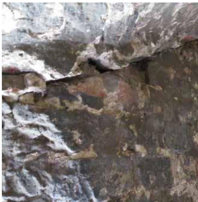
Afb. 44 De naad die zichtbaar is tussen het gewelf en het opgaande metselwerk van de trappenhuiswand. Het gewelf is op de wanden gelegd en er niet in verband mee opgemetseld (foto Monumentenbezit).
