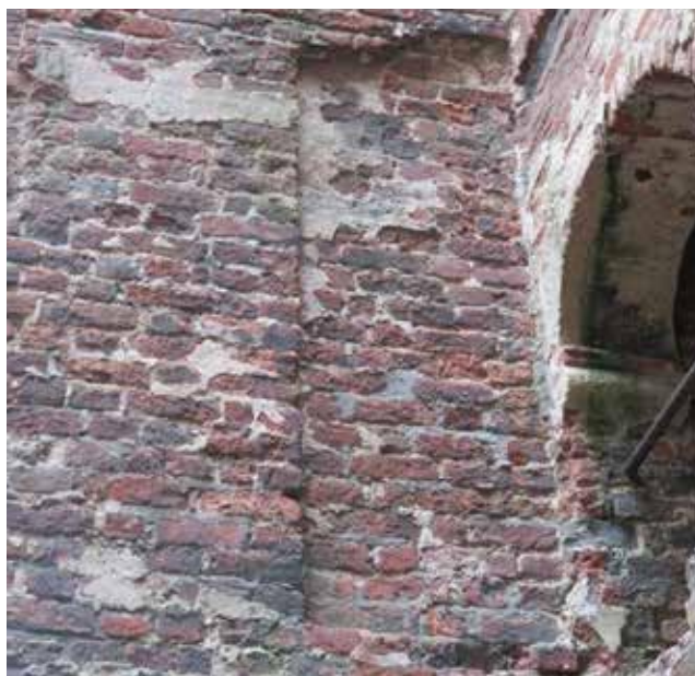
Afb. 46 De sparing in de westgevel waar de deur naar het trappenhuis in draaide. Deze sluit wat betreft breedte en hoogte goed aan op de korfboog en het veronderstelde niveau van de begane grond (foto Monumentenbezit).
