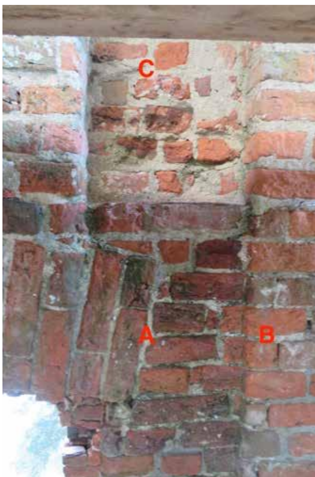
Afb. 62 Een muurstijlsleuf die in de rollaag boven een gevelopening (A) is gehakt (zie afb. 59 voor de positie). Bij B zijn een aantal bijgehakte stenen zichtbaar. De C geeft de balksparing boven de muurstijlsleuf aan (foto Monumentenbezit).
